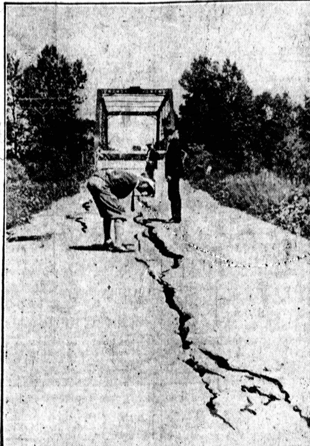
ZEME SUTRUKO. — Žemės drebėjimas Montanos valstijoje tiek žemę supurtė, kad ties Livingston, Mont., pasidarė plyšiai net ir cementiniame kely. Dėl žemės supurtymo pasi-darė didelių kalnų nuslinkimų, kurie pridarė nemaža nuostolių bet žmonių niekas nežuvo. Turistai Yellowstone parke buvo betgi labai išgąsdinti.
