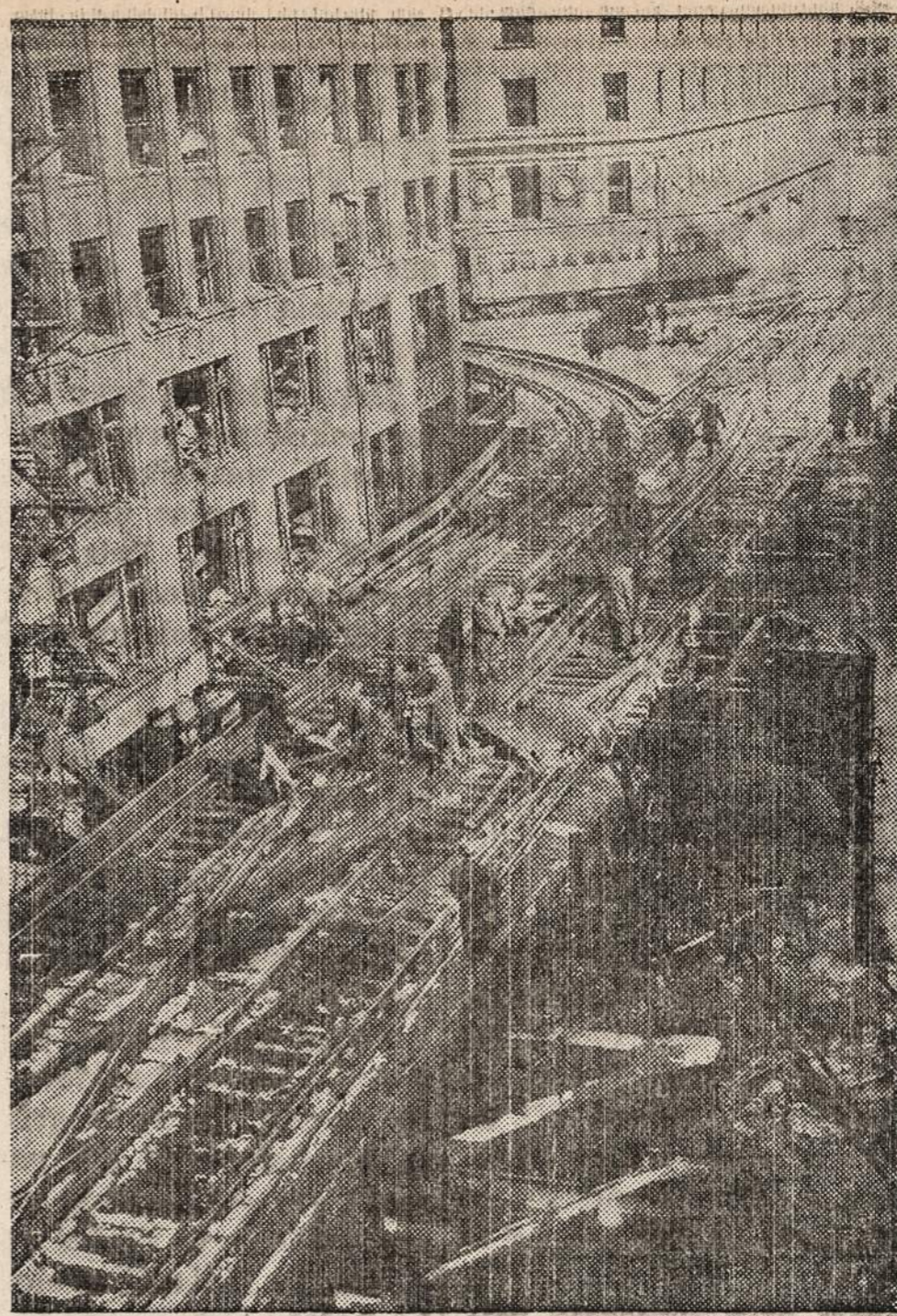
Viskas, kas pasiliko iš trijų aukštų namo, kuris eksplodavo Chicagos vidurmiestyje. Eksplozija buvo tiek galinga, kad dviejų kvartalų plote išbyrėjo trobesių langai. Apskaičiuojama, kad toji eksplozija vidurmiestiui padarė nuo $100,000,000 iki $150,000,000 nuostolių.
